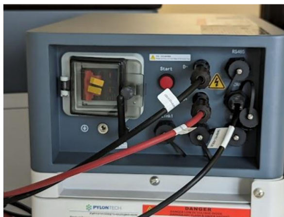
Figur 3. Bild från en färdig och korrekt utförd installation.
